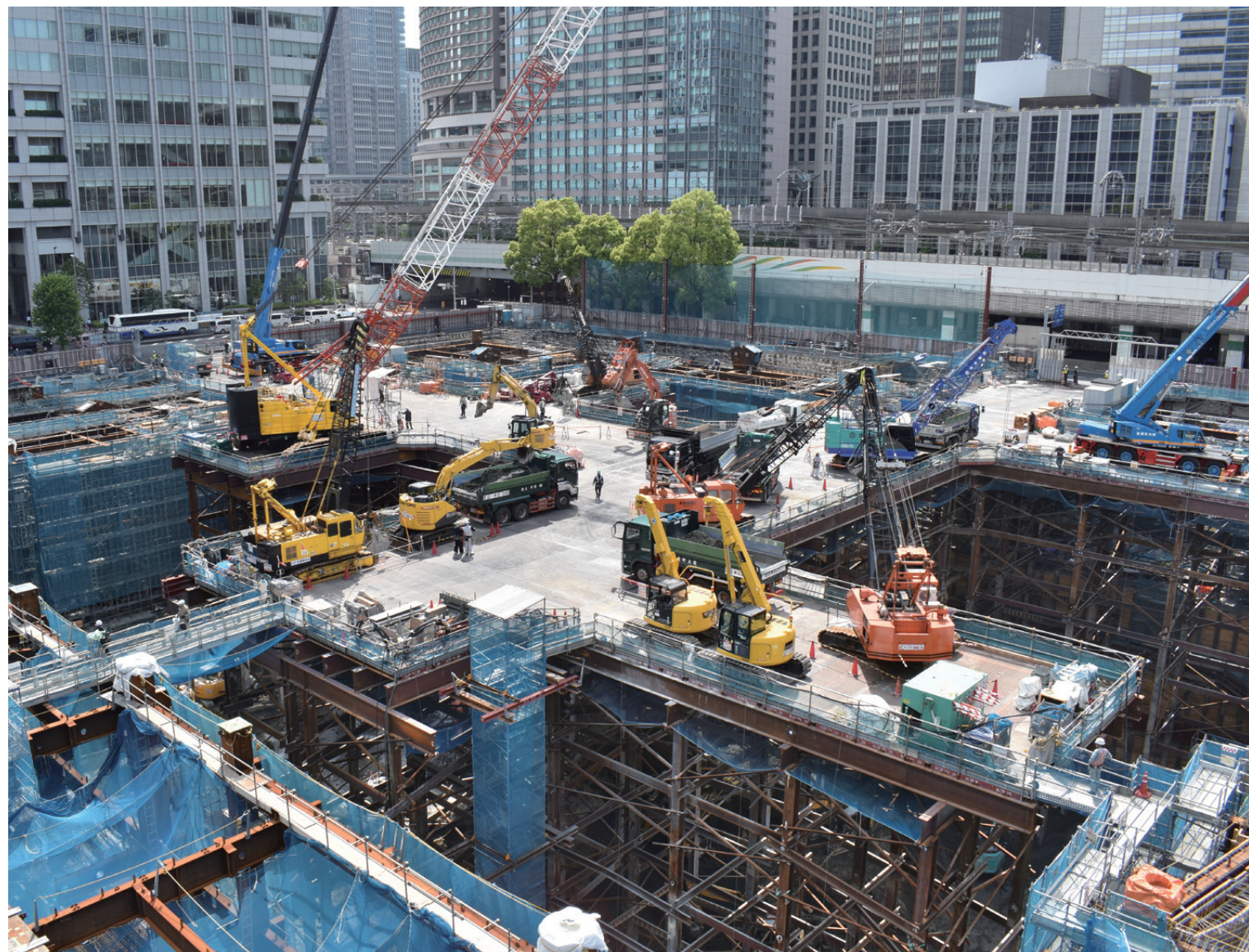
東京都千代田区 東京駅前常盤橋プロジェクト Torch Tower
