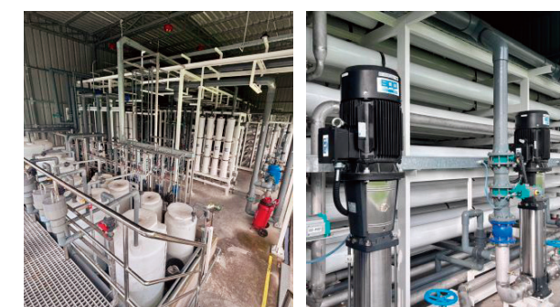
廃水処理に使用されるろ過設備
