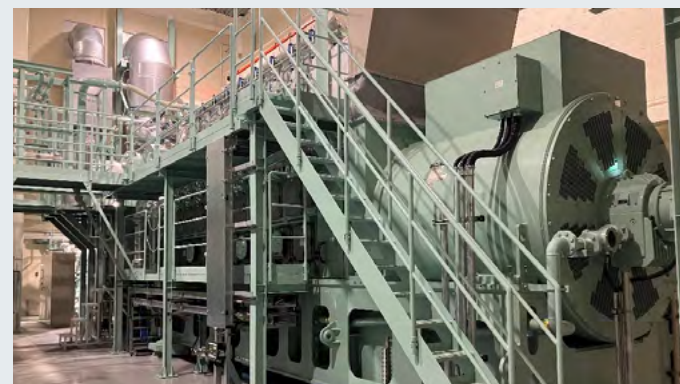
※画像は同型の既設ガスエンジン
