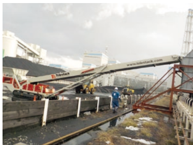
新たに設置した石炭簡易払出機
