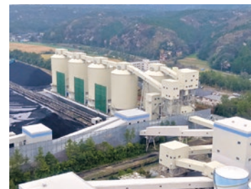
七尾大田火力発電所2号機 バイオマス燃料貯蔵サイロ・運搬設備
