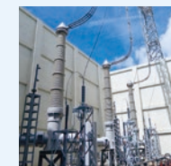
志賀中能登線ケーブル接続状態
