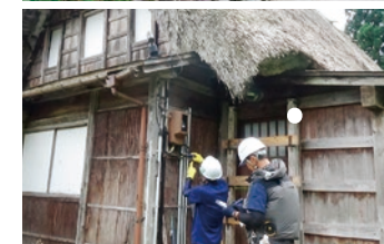
世界遺産「相倉合掌造り集落」の電気設備点検
