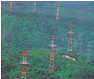
50万ボルト送電線
