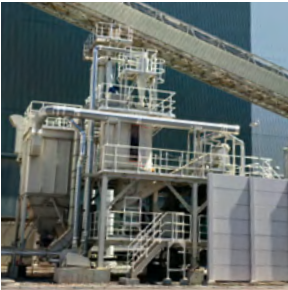
回収した粉じんを再度ペレット化し燃料として再利用する再造粒設備
