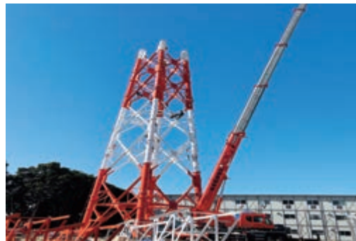
安定的かつ低廉な電力供給を支え続けるため計画的・効率的に設備形成を推進
