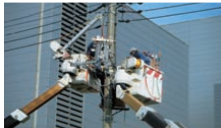
作業工程の組み替えや併行作業の拡大等により変圧器取替工事の時間を短縮
