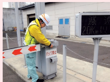
高速道路通信設備保守
