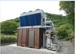
箱根湯の花プリンスホテル バイナリー発電設備
