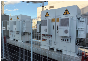
蓄電池設置の様子
