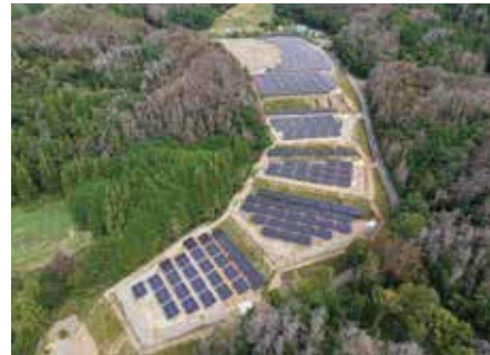
麻績運動場に設置した八十二グループ専用の太陽光発電所
