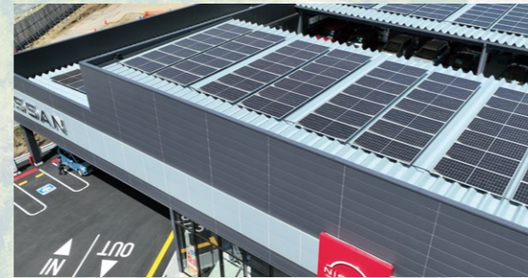
八王子店屋上のソーラーパネル
