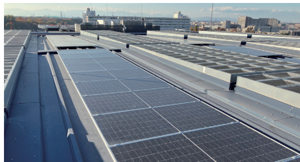
西東京データセンター2号棟屋上に設置した太陽光発電設備
