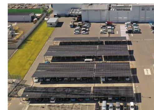
青木食品の太陽光パネル
