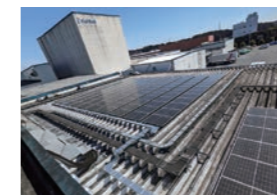
筑波工場のソーラーパネル
