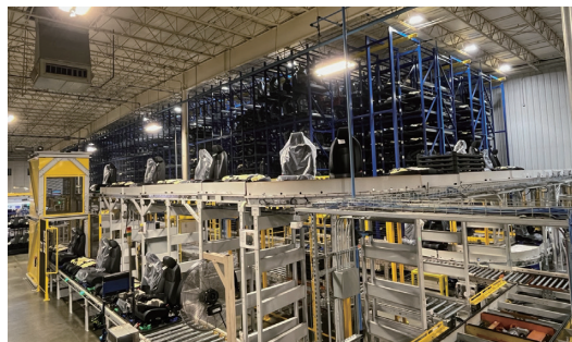
立体自動倉庫
