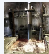
アルミ保持炉を保温する電気ヒーター
