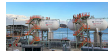
アンモニア供給設備
