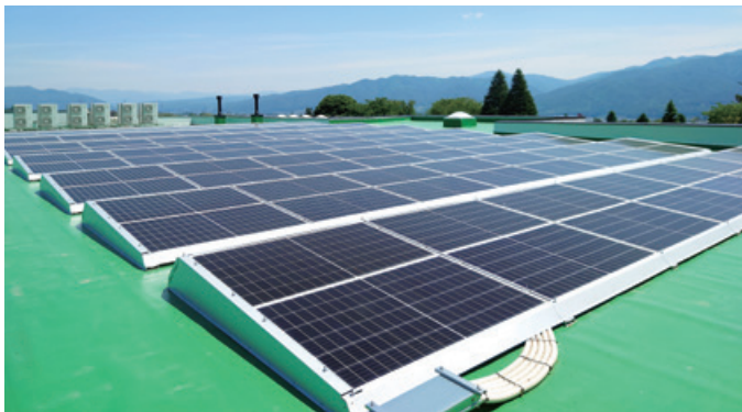
アンカーレス架台によって設置された太陽光パネル
