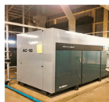
エアコンプレッサー
