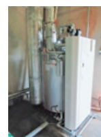
ガス炊きスチームボイラー
