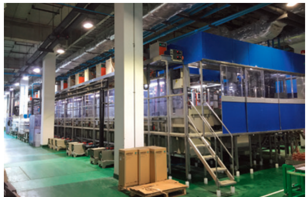
銅めっき設備
