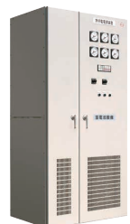
無停電電源装置
