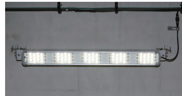
直流給電方式のLEDトンネル照明
