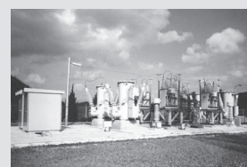
配電自動化システム
