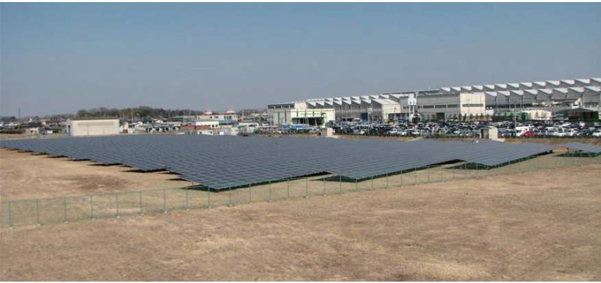
太陽光発電設備(小山事業所)
