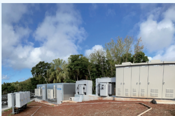
母島に設置された太陽光発電設備
