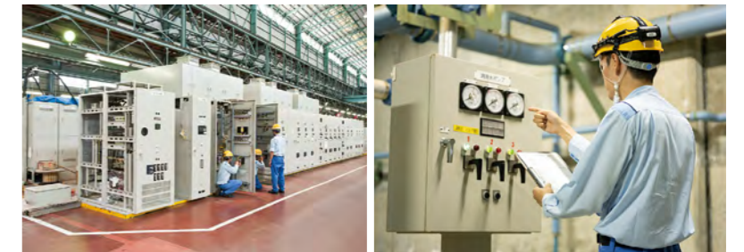
社会システム分野にも納入の多い配電盤
