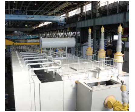
拡張した変圧器工場試験エリア
