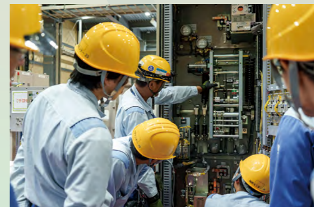
実機を使用したメンテナンス技術研修
