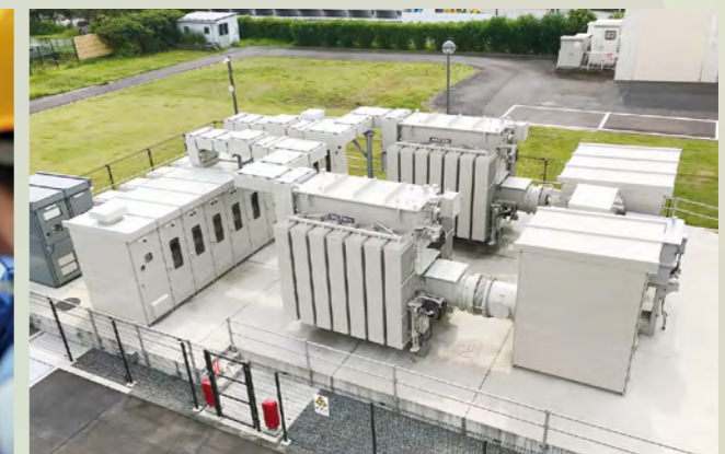
IoTセンサーを取り付けたGX特高変電所
