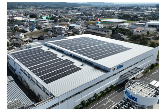
三共エクセル 工場屋根 太陽光発電設備 ・CO 2 削減量：286t-CO 2 /年間(見込み)
