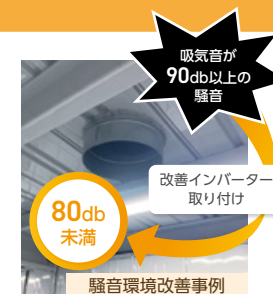
騒音環境改善事例
