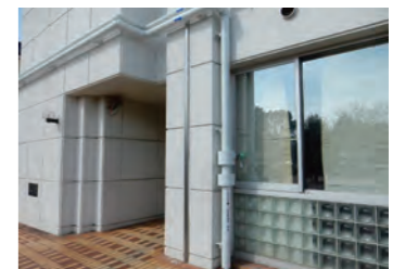
地上化した上水配管
