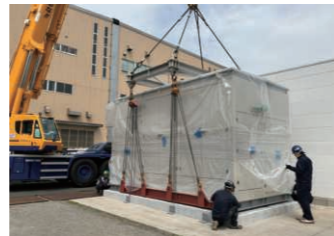
当社川崎製作所に設置中の二酸化炭素回収装置実証機 (2024年6月)
