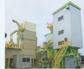
石膏系固化材製造設備 乾燥した石膏粉から半水石膏を製造し、セメントや石灰とブレンドすることで固化材を製造するプラント設備
