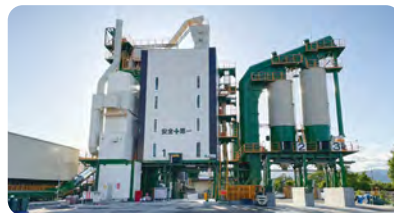
■ アスファルトプラント (AP 関連事業)
