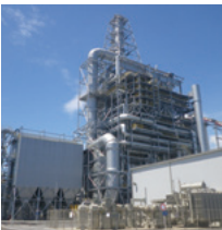
循環流動層（CFB）ボイラ
