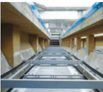
汚泥かき寄せ機
