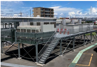
かさ上げ後の発電・空調設備
