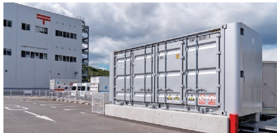
大型蓄電池を活用した電力最適化サービスを導入した岡山郵便局（岡山県）
