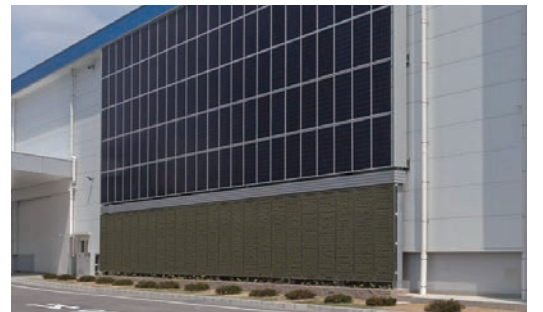
Dream Site 1 壁面太陽光パネル
