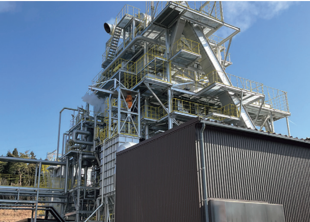
バイオマス発電プラント （SGE土岐バイオマス合同会社）
