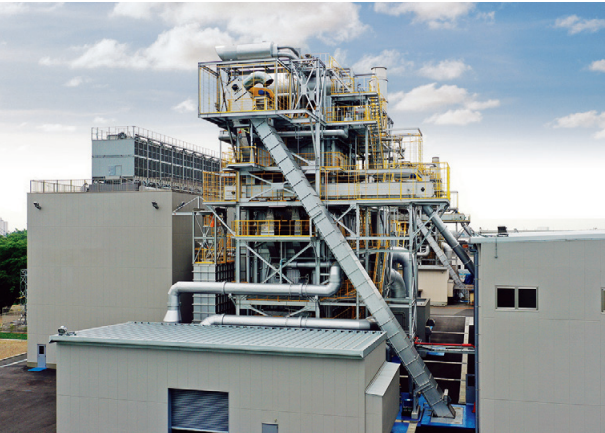
バイオマス発電プラント
