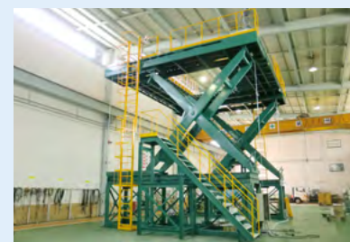
発電機タービン組立足場用リフトテーブル
