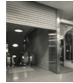
エスカレーターまわりに設置された防火防煙シャッター
