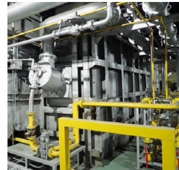
再生重油からガスへエネルギー転換
