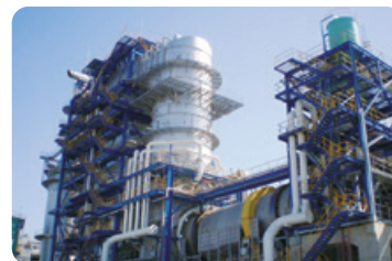
焼却処理プラント
