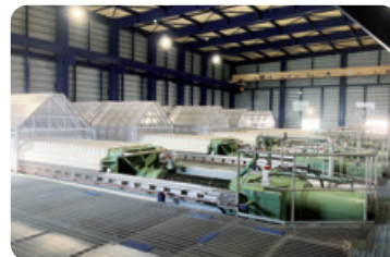
新設した亜鉛工場の設備
