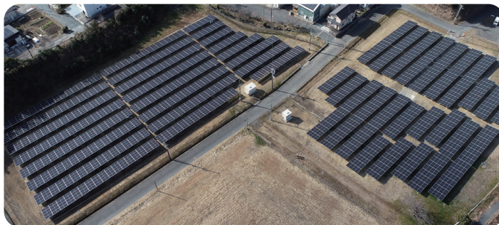
当社遊休地に設置した太陽光発電所
