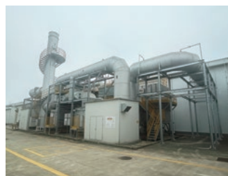
阿基里斯(佛山)新型材料有限公司の排煙処理設備
