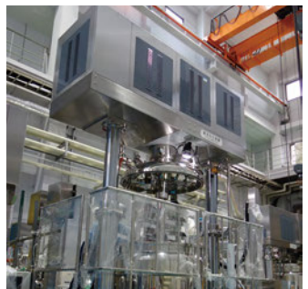
乳化プラント
