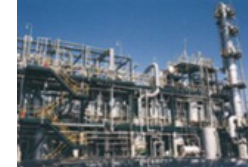
磐田工場メントール製造プラント
