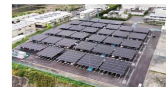
高萩工場カーポート型太陽光発電設備
