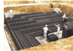
豪雨対策に貢献する雨水貯留槽
