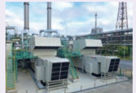
ガスタービン発電機
