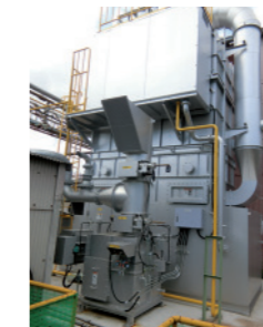
環境汚染物質の除害設備
