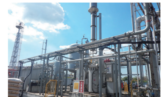
水島工場 水素ボイラー設備
