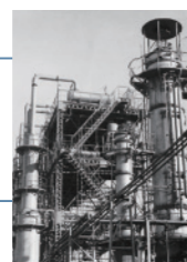
トリクロロールエチレン製造設備
