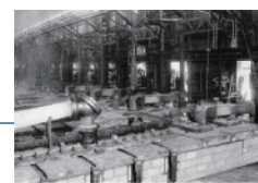
金属マグネシウム電解槽
