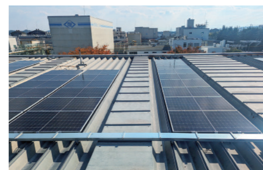
渋川工場 太陽光発電設備
