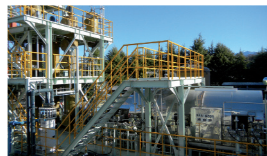
温室効果ガスの除害設備
